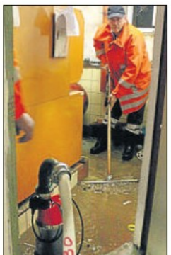
Schlammbrühe: Mit einer Pumpe wurde dieser Heizungskeller in Volpriehausen leergepumpt.
