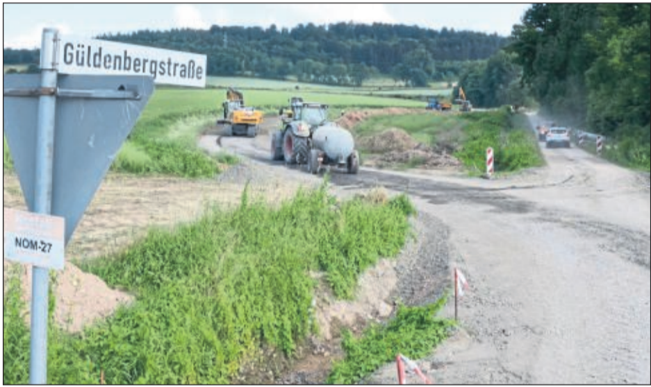
Baustraße ist schon Teil der neuen Bundesstraße: An der Güldenbergstraße bei Bollensen fahren jetzt Baufahrzeuge auf der Schotterstraße (links), die als Querspange später Teil der Abfahrt von der Bundesstraße wird. Der Zuweg zur Schweineweide (rechts) bleibt.
