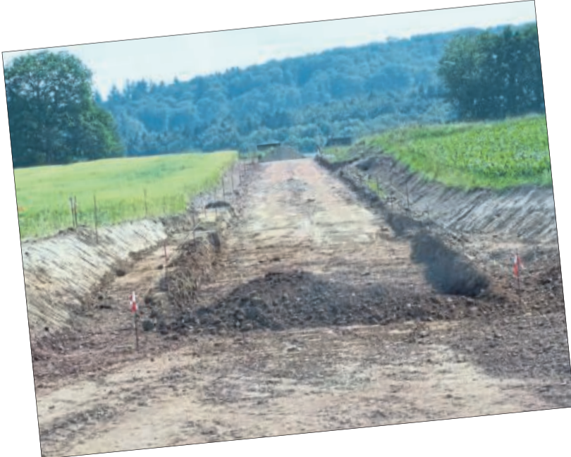
Baustraße für Schwerlastverkehr: Eine der fünf Baustraßen für die neue Bundesstraße entsteht direkt nach dem Ortsausgangsschild Richtung Gierswalde. Sie wird für hohe Traglasten angelegt und asphaltiert und soll vielleicht zurückgebaut werden. Fotos: Jürgen Dumnitz
